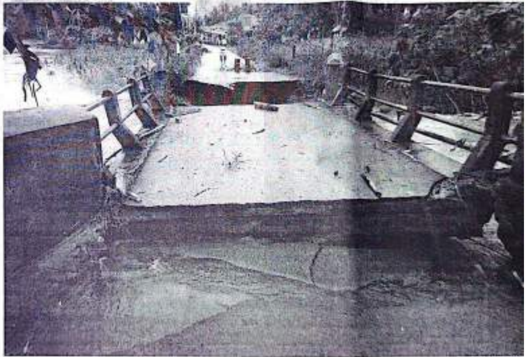
JEMBATAN AMBRUK — Kondisi jembatan Korong Pinang, Pauh Kamba, Kecamatan Nan Sabaris, Kabupaten Padangpariaman, ambruk akibat banjir pada Kamis (7/3) lalu. Hingga kini kondisi jembatan belum bisa dilalui.
